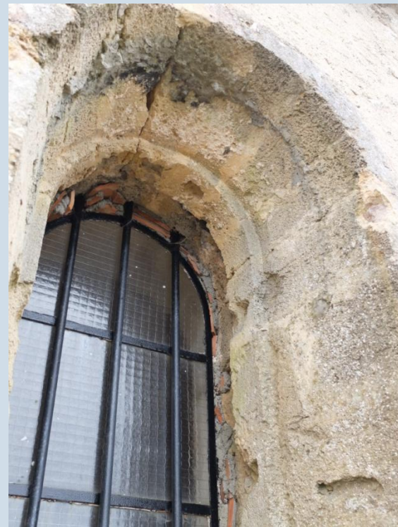
Grilles retirées, embrasures dégradées
