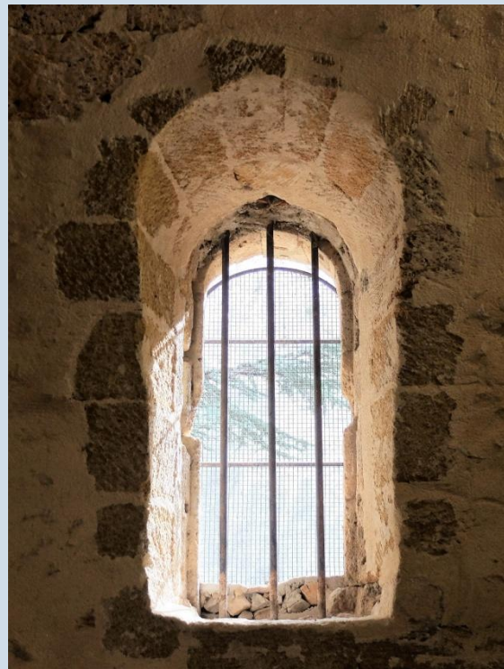
Vitres retirées, les feuillures endommagées sont plus visibles
