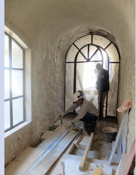
Début octobre 2017, reprise du dallage en pierres de taille, dans la partie restaurée en 1972
