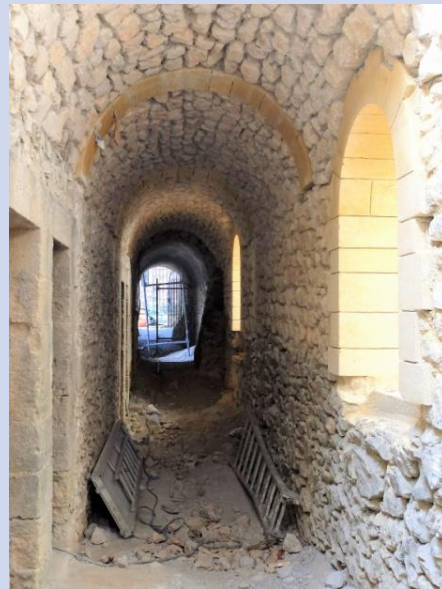
Fin février 2017, le gros œuvre est achevé, il manque l'enduit et le sol dallé
