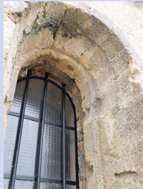
Grilles retirées, embrasures dégradées
