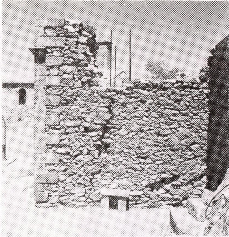
Le mur Sud du monastère strié d'une lézarde en 1958.
