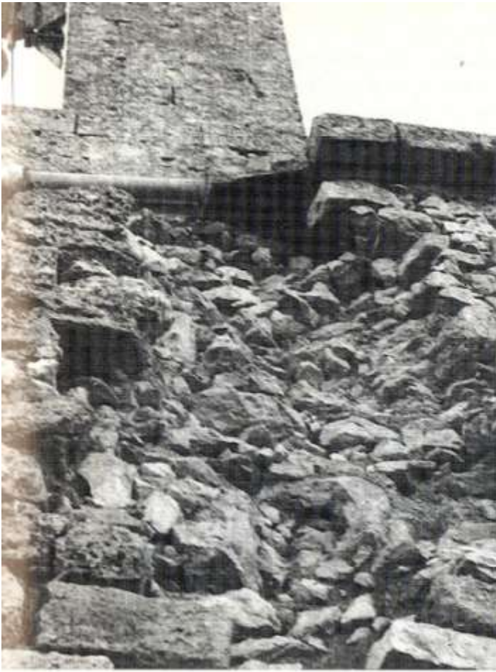
Clocher et mur nord de la chapelle l'éboulement en 1958 (photo H. Imoucha)
