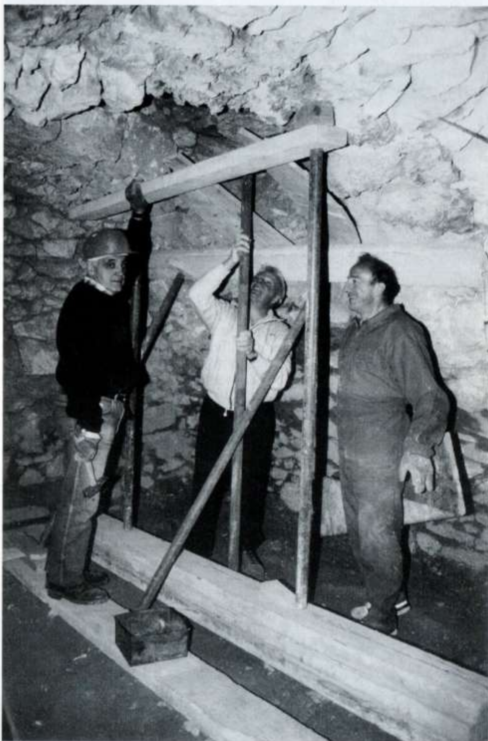
Travaux de réfection de la cave E. Decanis, L. Portail, J. Girard. (Photo J. Cathala)
