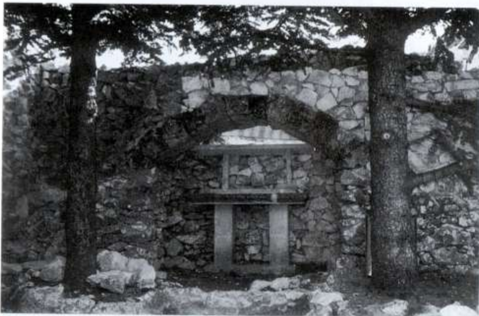
Reconstruction du mur au-dessus de l'hotel en plein air en 1994. (Ph. François Colin).
